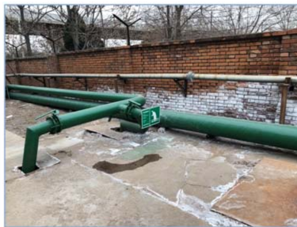
东厂区生产废水排污口
