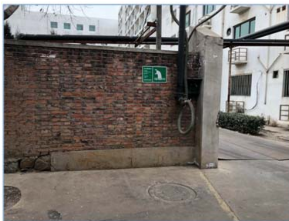
西厂区生活污水排污口
