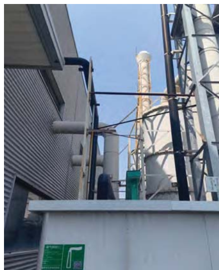
DA004 排气筒及标识牌
