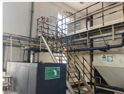
DW002 污水排放口标识牌
