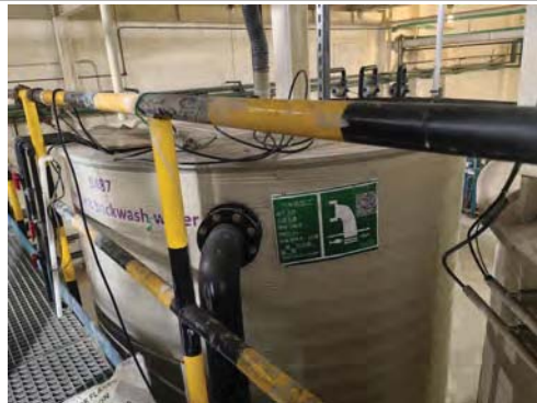
DW001 污水排放口标识牌
