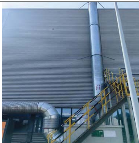
DA009 排气筒及标识牌
