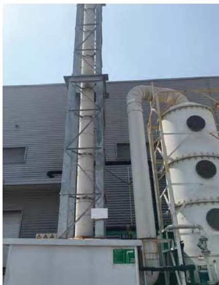
DA003 排气筒及标识牌
