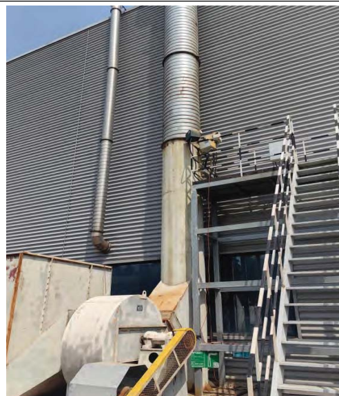
DA007 排气筒及标识牌
