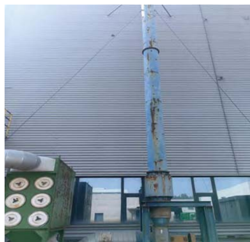
DA010 排气筒及标识牌
