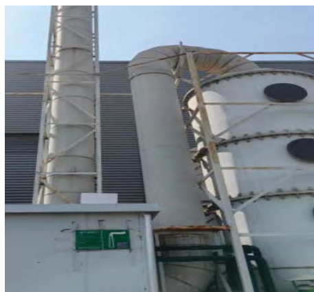
DA001 排气筒及标识牌
