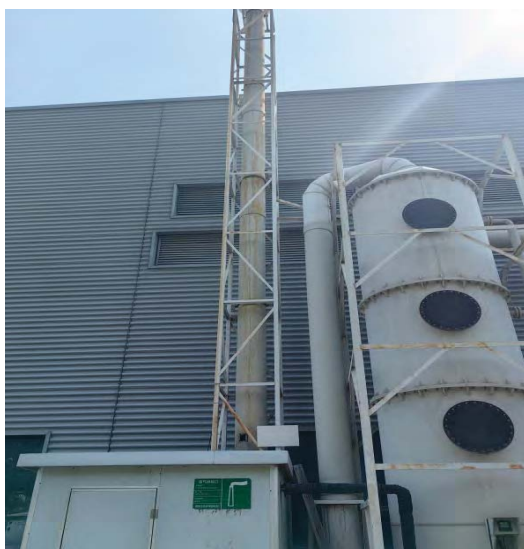
DA005 排气筒及标识牌
