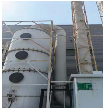
DA002 排气筒及标识牌
