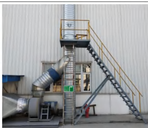
注塑废气排气筒采样平台、采样口、标识牌
