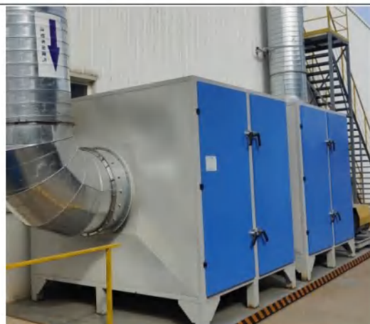
注塑废气二级活性炭处理设施
