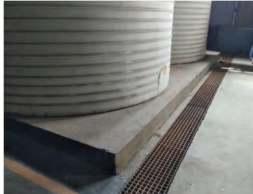
电镀废水处理站四周导流沟
