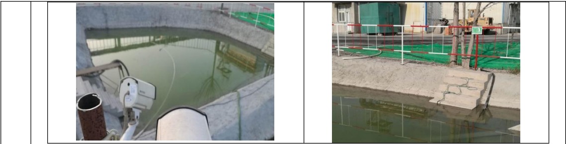
图 2-7 厂区集水池（2700m 3 ）
